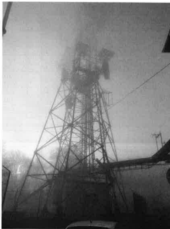
Zał. nr 1: Widok ogólny instalacji radiokomunikacyjnej.
