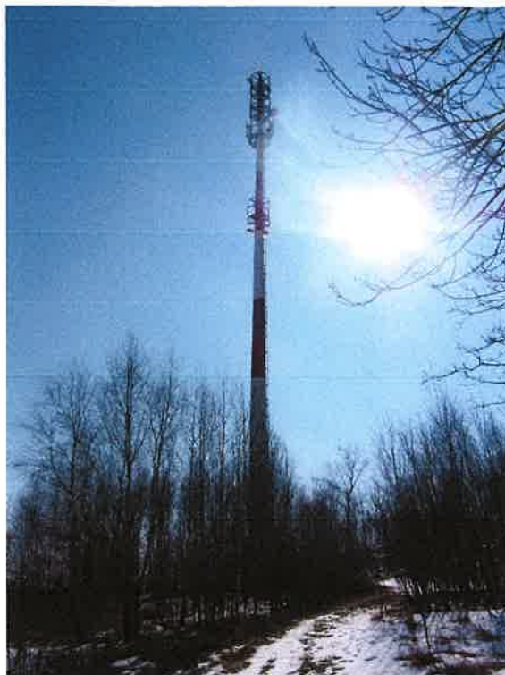
Zał. nr 1: Widok ogólny instalacji radiokomunikacyjnej.
