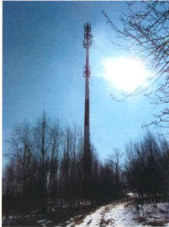
Zał. nr 1: Widok ogólny instalacji radiokomunikacyjnej.
