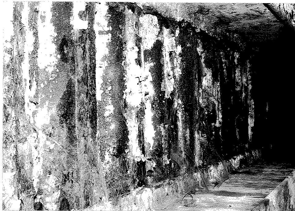
Rys. nr 25. Widok szczegółowy od spodu konstrukcji pomostu z kształtowników Zoresa. Widoczna korozja obejmująca prawie całą powierzchnię kształtowników Zoresa.
