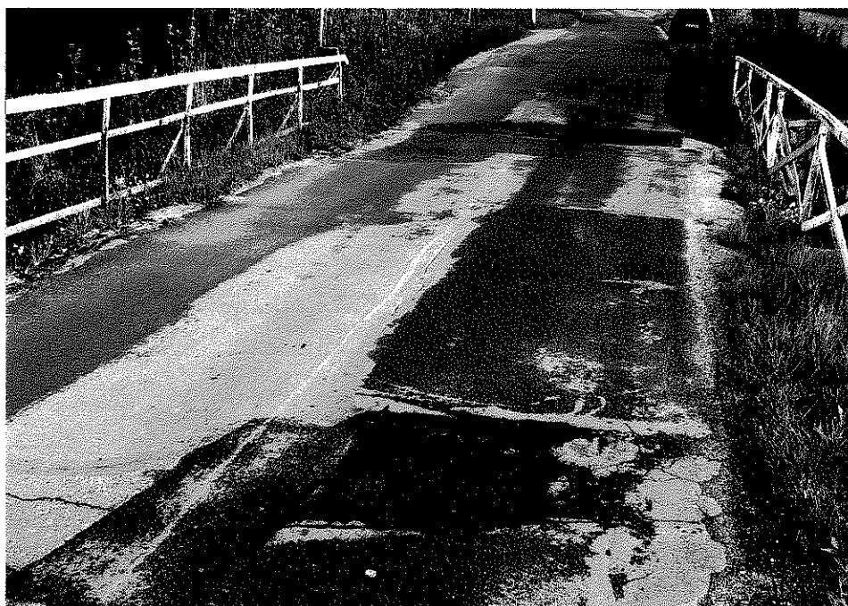
Rys. nr 8. Widok ogólny od strony Kolc nawierzchni na moście . Widoczne miejscowe uszkodzenie nawierzchni.
