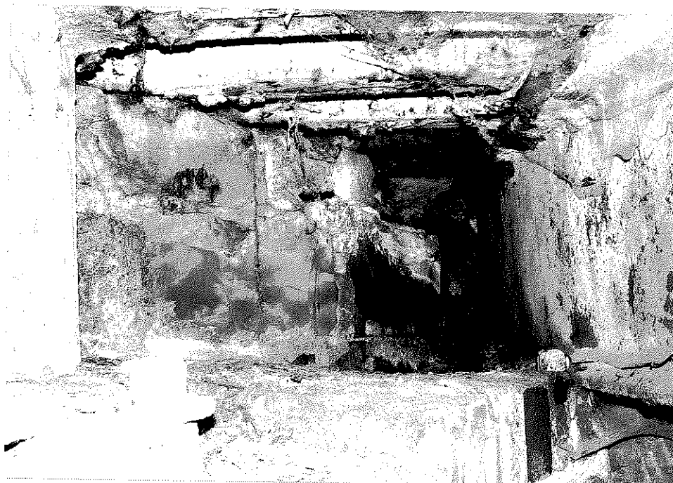
Rys. nr 18. Widok szczegółowy ścianki żwirowej i oparcia dźwigarów na ławie podłożiskowej z elementów kamiennych i ceglanych. Widoczny brak części ścianki żwirowej.
